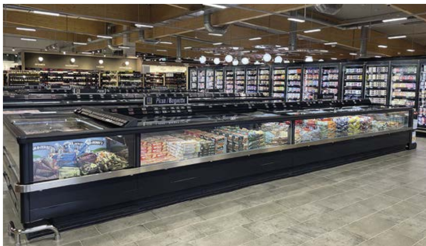
Anwendung im Einzelhandel: Mit CO 2 gekühlte Tiefkühltruhe am Point of Sale im Supermarkt
